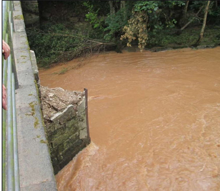
Abbildung 8: Beschädigung am mittleren Brückenpfeiler
